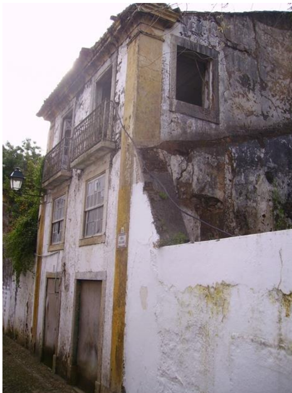
Fotografia 15 - Exemplo de um edifício em péssimo estado de conservação
